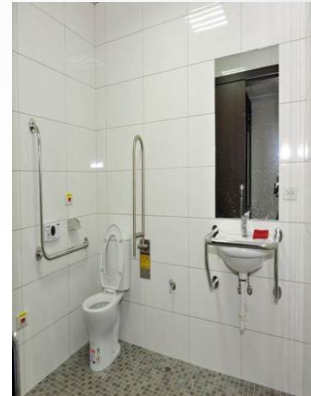
無障礙房衛浴設備
